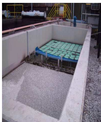
大型油水分離槽
